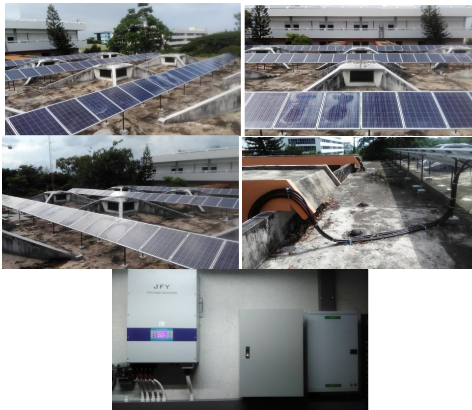
ภาพที่ 3 แสดงการติดตั้งแผงโซลาร์เซลล์และอินเวอร์เตอร์
